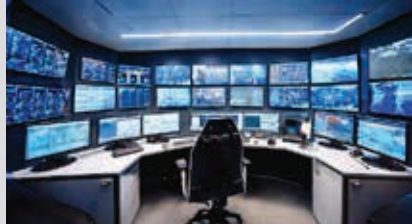
CUARTO DE CONTROL
